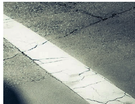
▲道路のひび割れ
